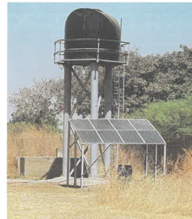
Pozzo profondo e pompa solare. Foto: BEOGO, Yelemani.
